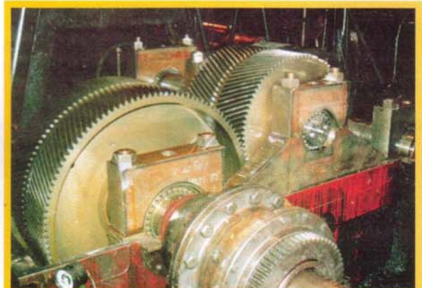
Schwerer Walzenantrieb Heavy mill drive
